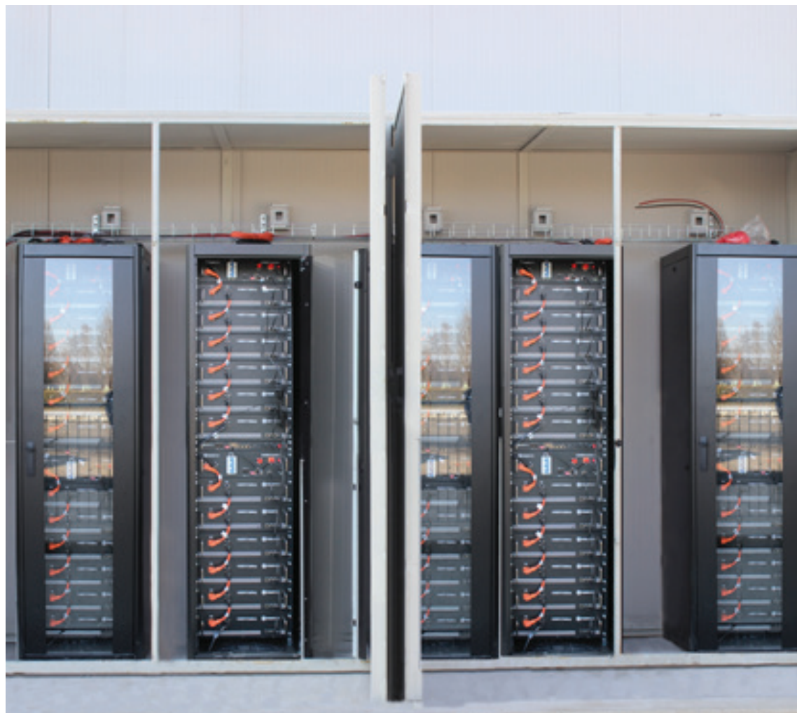
OGNI INVERTER IBRIDO È CONNESSO AD UN ACCUMULO CON CAPACITÀ DI 42 KWH, REALIZZATO CON DUE PILE IN PARALLELO DA SEI BATTERIE PYLONTECH, CON CAPACITÀ DI ACCUMULO DI 3,5 KWH CIASCUNA
